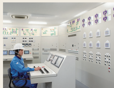
コントロールセンター
