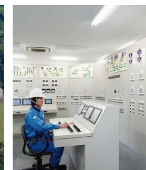
全工程を管理するコントロールセンター
