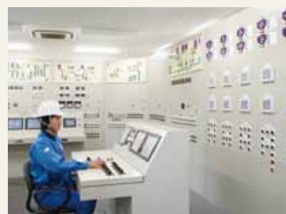
コントロールセンター
